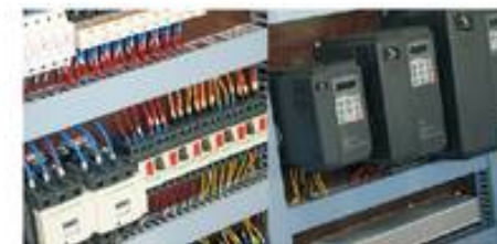
电器部分 Electric appliance unit
